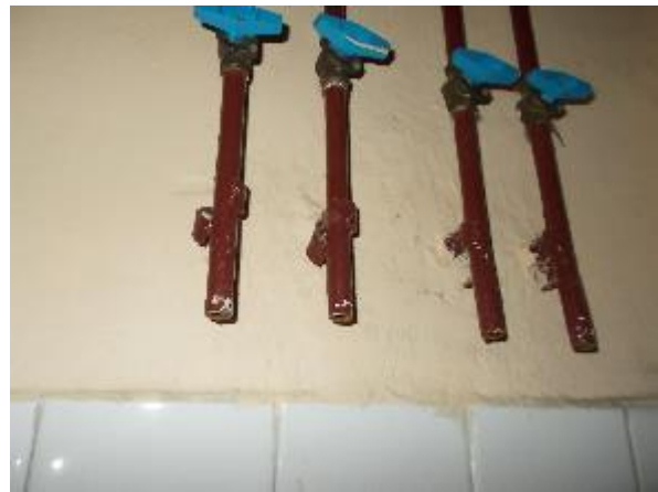
Italdiszkont elvágott radiátorcsövek
