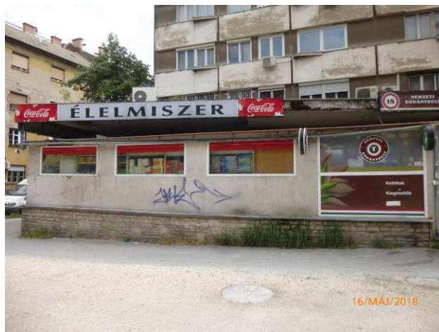
homlokzat , bontandó beépített terasz
