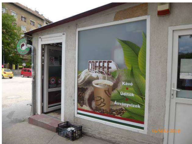
homlokzat, bontandó beépített terasz
