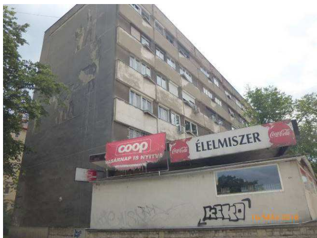
homlokzat, bontandó beépített terasz
