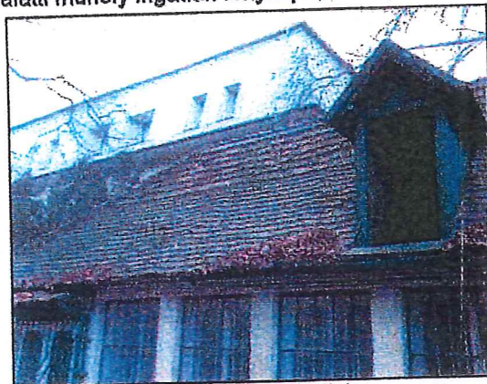
Elhanyagolt, beázó tetőszerkezet
