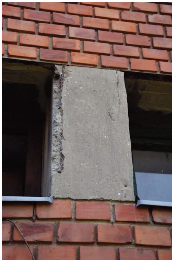
Sérült vasbeton nyílásosztó a középső épület homlokzatán.
