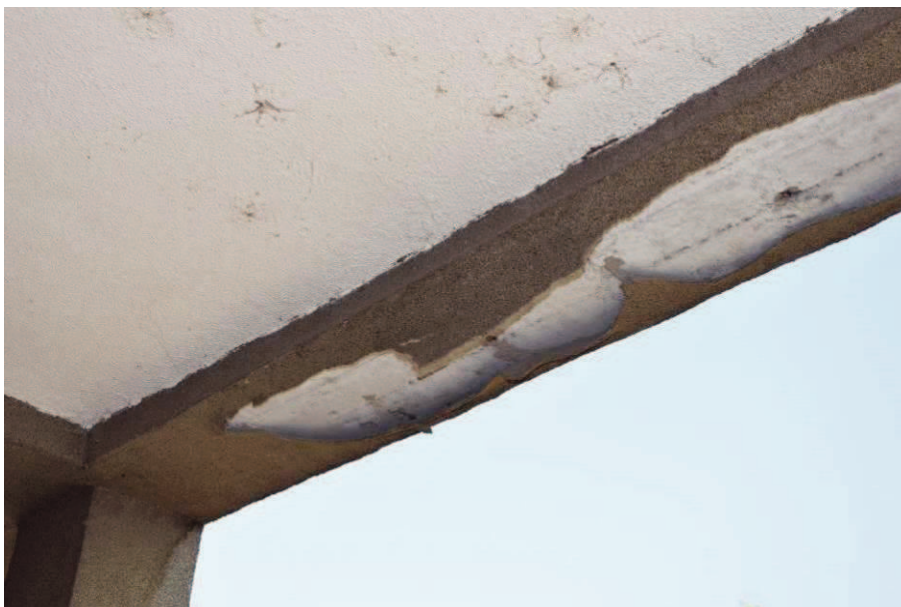
Vasbeton szerkezet részlete; sérült szerkezet a loggián.
