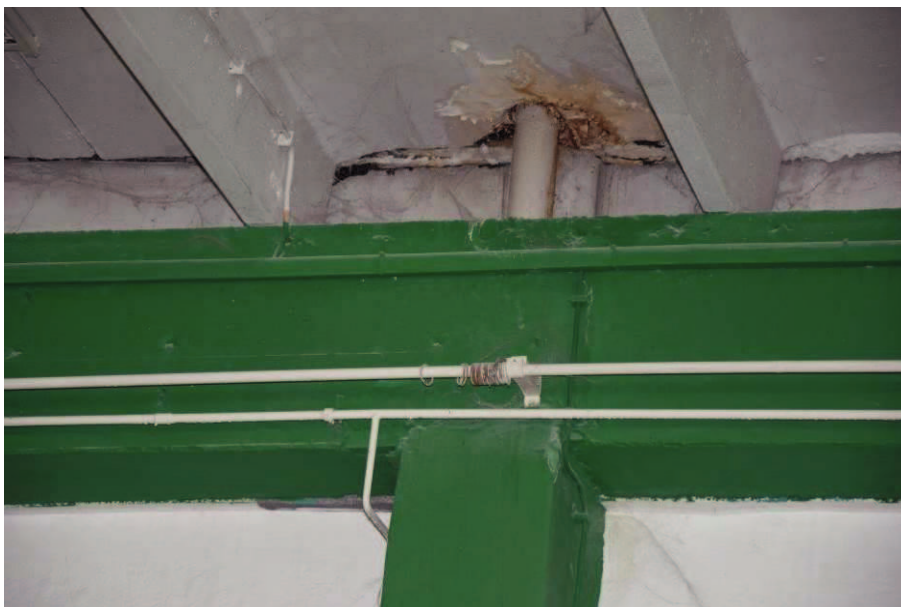
Lefolyó átvezetése sérült tetőpanelen.
