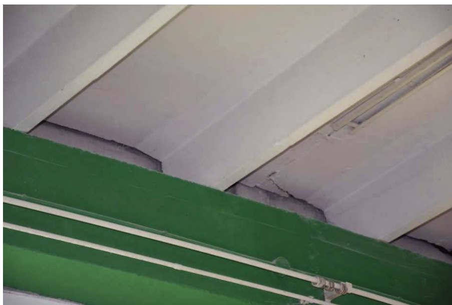
Repedt, kapcsokkal erősített tetőpanel.
