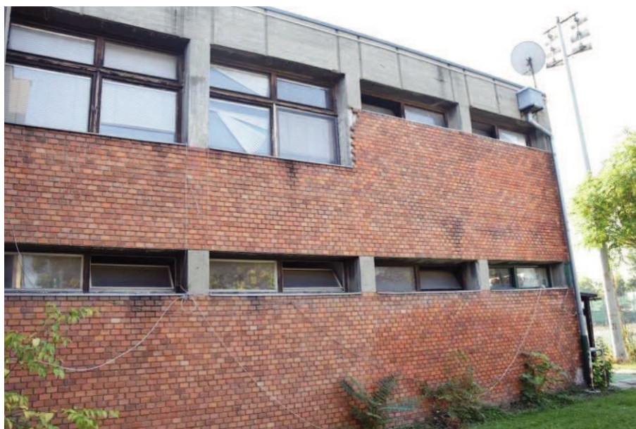
A középső épület északnyugati oldala, látható burkolati sérülésekkel.
