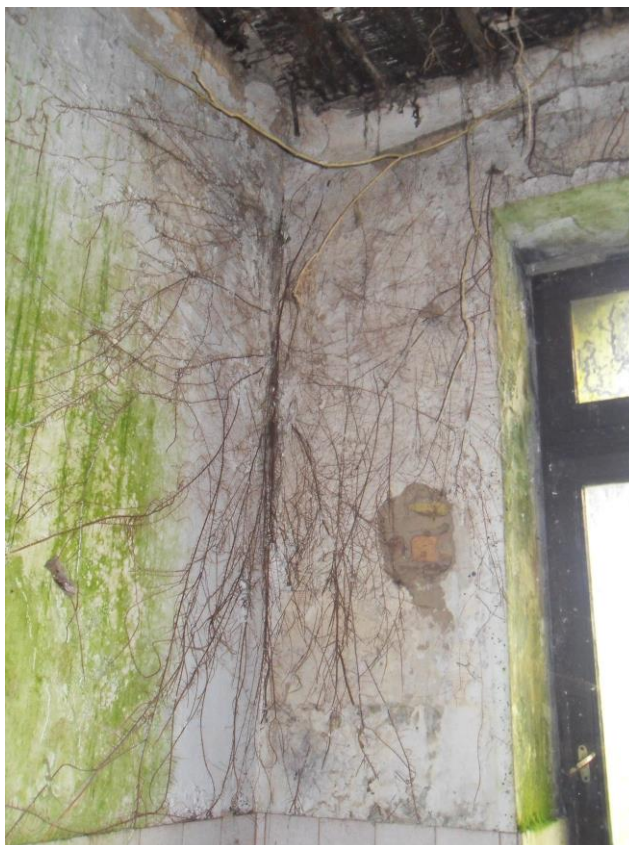
3. ábra Falszerkezet károsodásai
