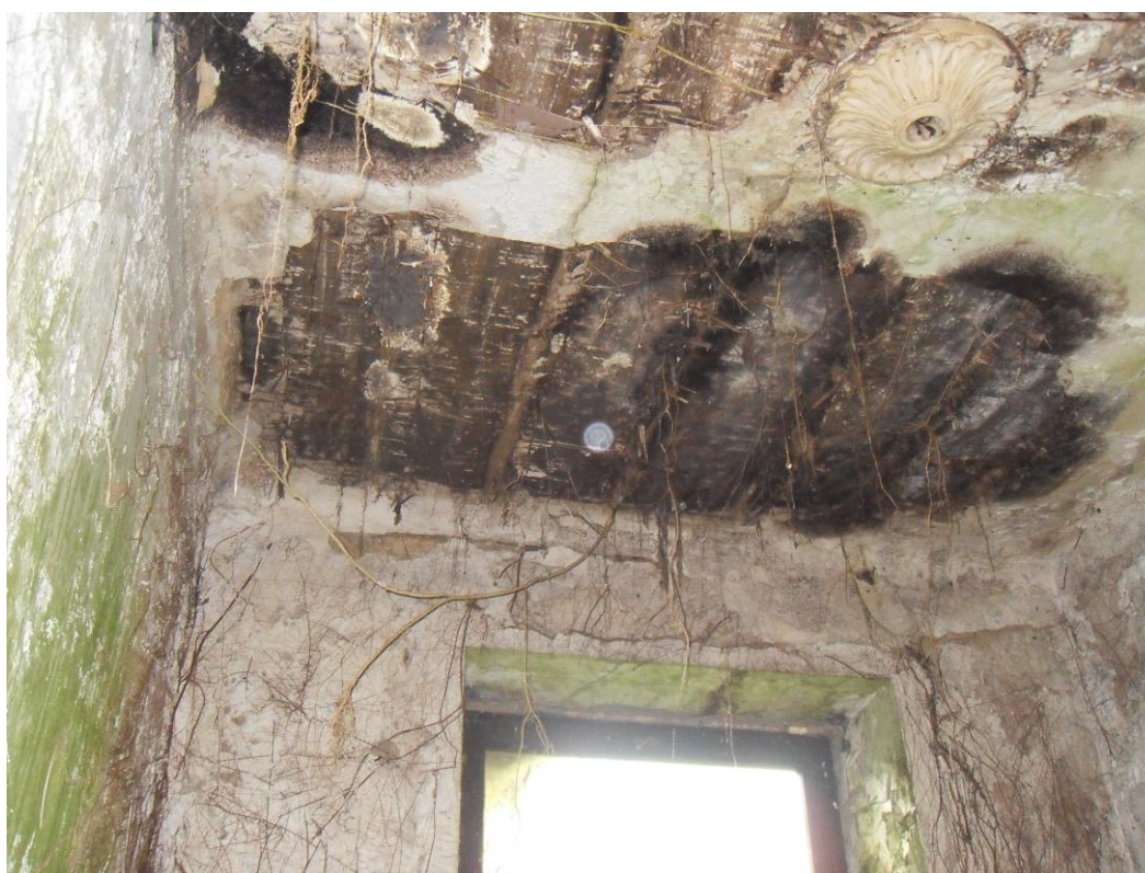
2. ábra Fafödém gomba károsodásai
