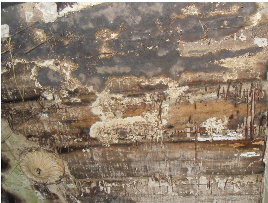
1. ábra Fafödém gomba károsodásai
