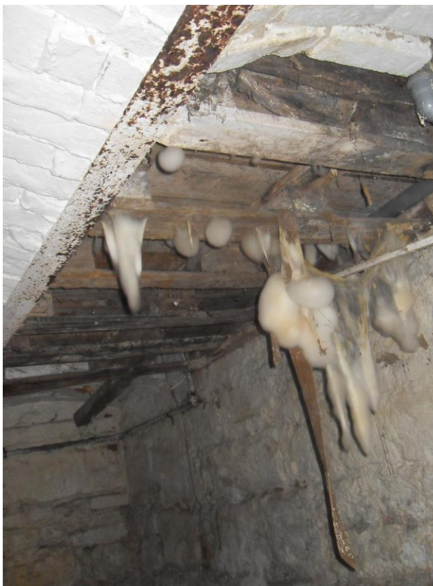
4. ábra Pince földm gomba károsodásai
