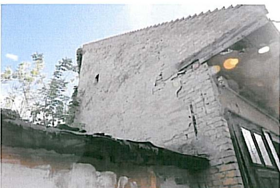
5. fénykép Hátsó tűzfal
