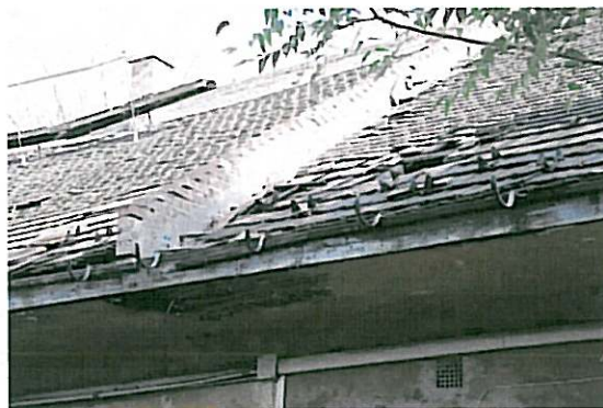
32. fénykép Hiányzó ereszcsonna
