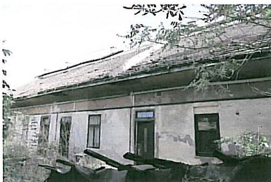
31. fénykép Hiányzó ereszcsonna
