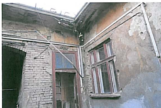
33. fénykép Hiányzó ereszcsonna, leszakadt ereszalj
