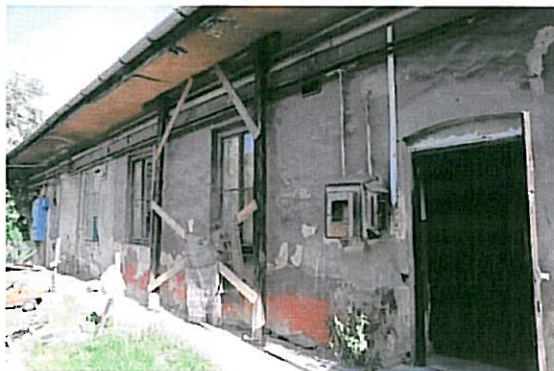
6. fénykép Repedések, dúcolt ereszalj
