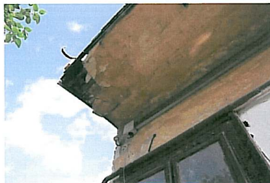
34. fénykép Hiányzó ereszcsonna, leszakadt ereszalj
