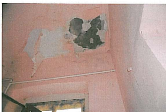
16. fénykép Ázás, födém károsodás
