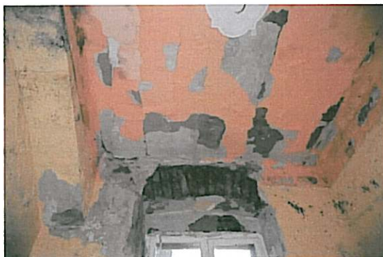
9. fénykép Vakolat hibák
