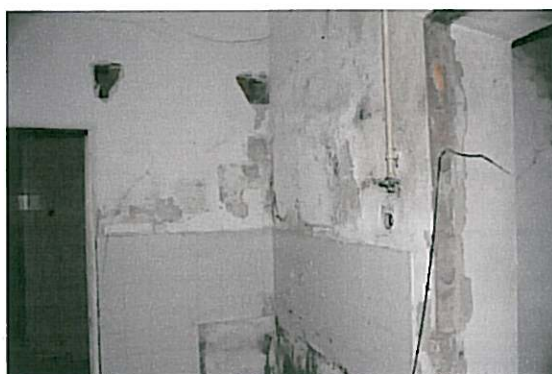
11. fénykép Vakolat hibák, veszélyes áll. szerelvények
