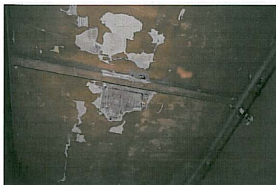
14. fénykép Ázás, födém károsodás
