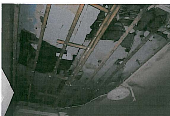
18. fénykép Ázás, födém károsodás
