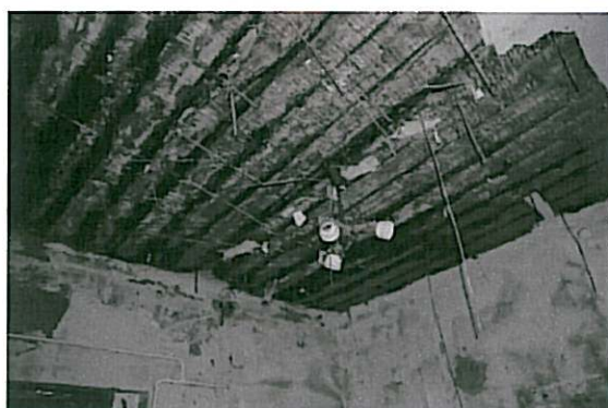
17. fénykép Ázás, födém károsodás
