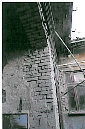
8. fénykép Vakolat hibák, hiányzó ereszcsonna
