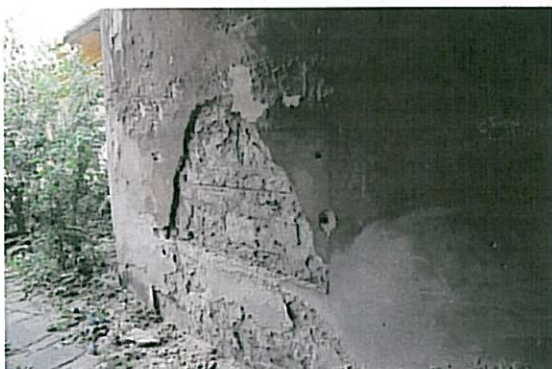
7. fénykép Vakolat hibák
