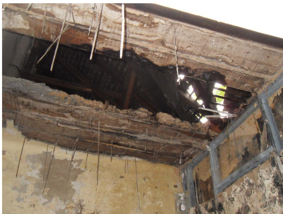
2. ábra Zárófödém károsodásai
