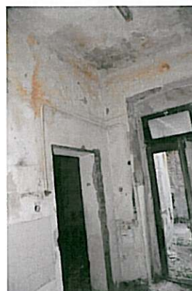
10. fénykép Falhibák, ázás
