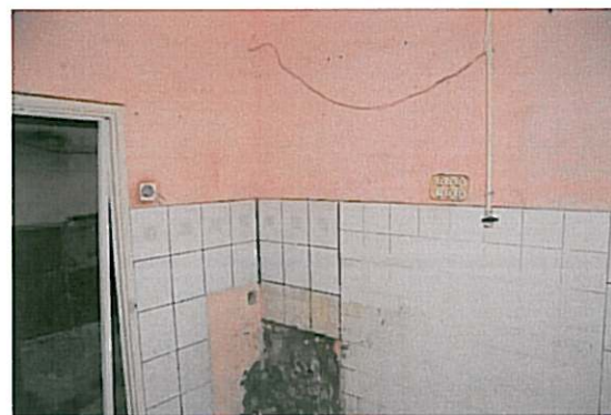
36. fénykép Veszélyes állapotú szerelvények
