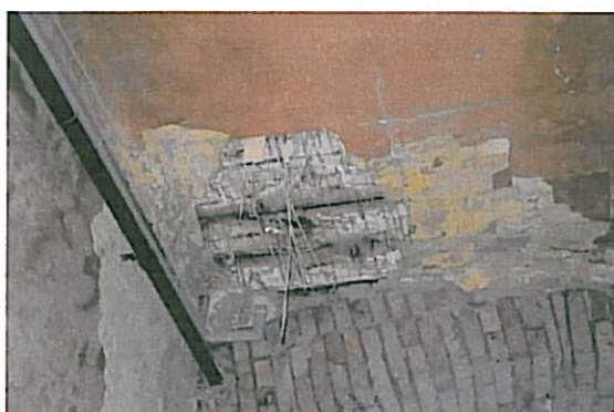
15. fénykép Ázás, födém károsodás
