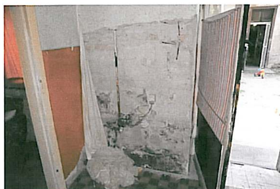
35. fénykép Veszélyes állapotú szerelvények
