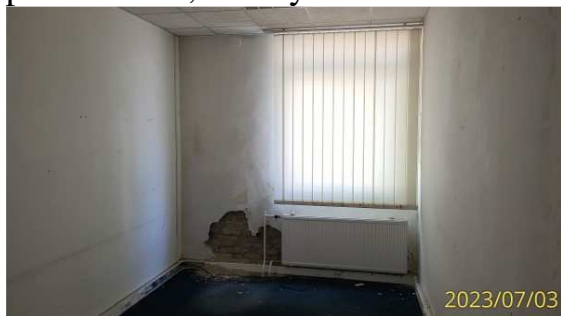
Vizsgált ingatlan belső tere, vakolat leválás
