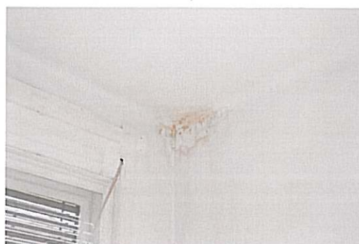
20. fénykép Repedések, penész
