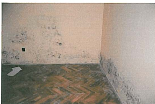
15. fénykép Ázás, penész
