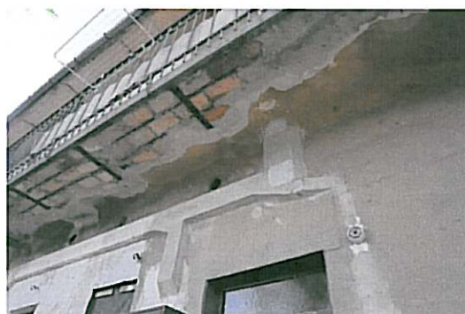
30. fénykép Vakolat hullás, rozsdásodás
