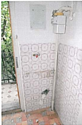
33. fénykép Veszélyes állapotú szerelvények
