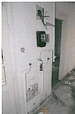
35. fénykép Veszélyes állapotú szerelvények
