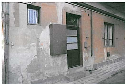
8. fénykép Repedések, vakolási hibák
