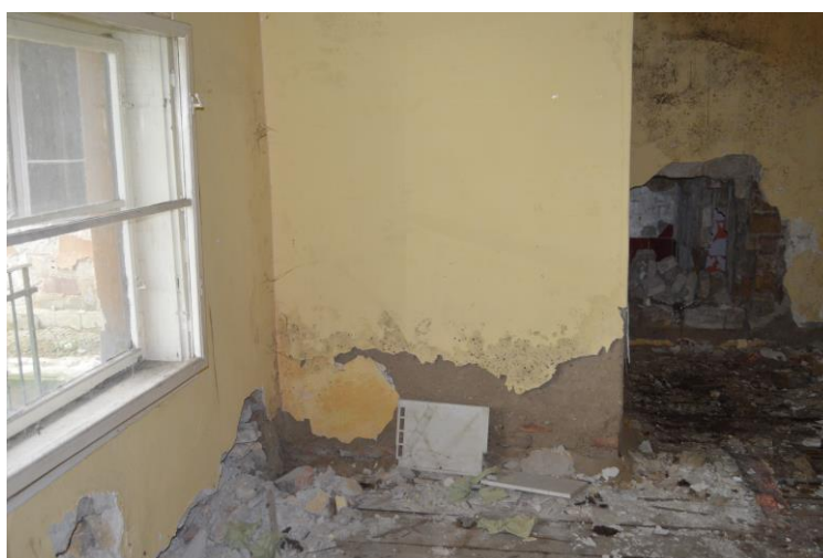
3. ábra - Falszerkezet károsodása
