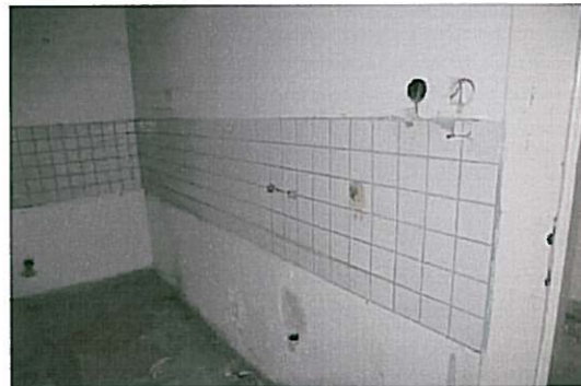
34. fénykép Veszélyes állapotú szerelvények
