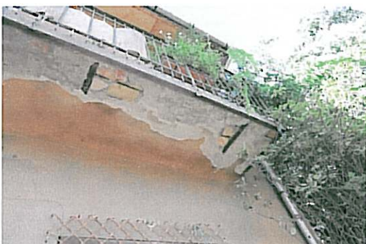
29. fénykép Vakolat hullás, rozsdásodás
