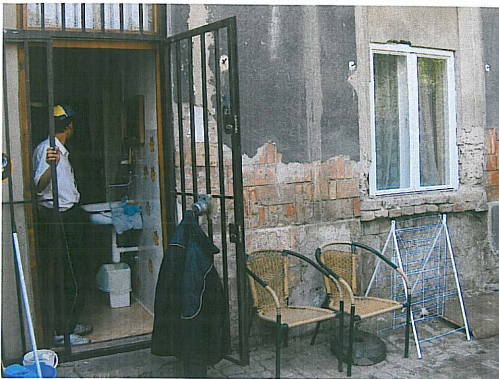
1. fénykép A lakás bejárata és az ablak környezete
