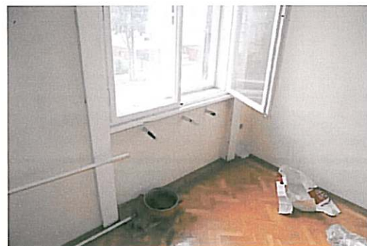
36. fénykép Veszélyes állapotú szerelvények
