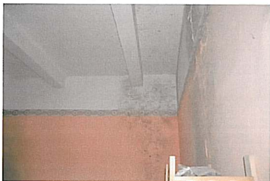
19. fénykép Repedések, penész
