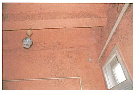
18. fénykép Ázás, penész, repedés
