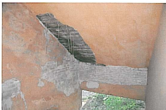
17. fénykép Vakolat hullás
