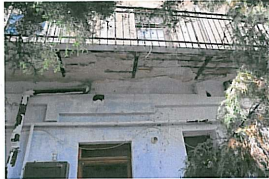
32. fénykép Vakolat hullás, rozsdásodás
