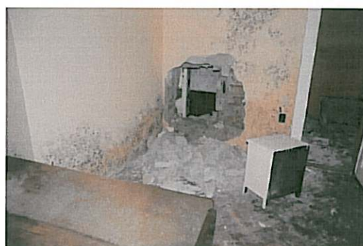
16. fénykép Ázás, penész, bontás
