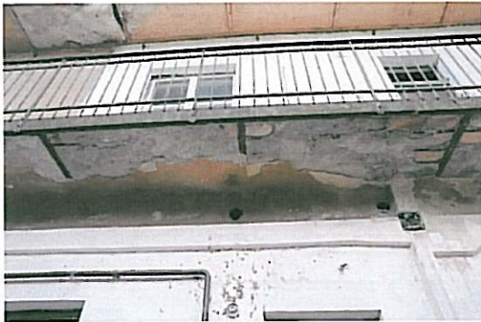
31. fénykép Vakolat hullás, rozsdásodás
