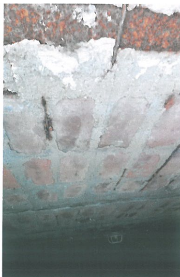
A társalgó alatti födém korrodált acélgerendája
