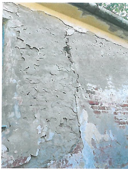
Süllyedési repedés a főfalon
